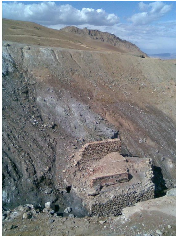
تصویر ۱- ساختمان حمام آبگرم تخریب شده
